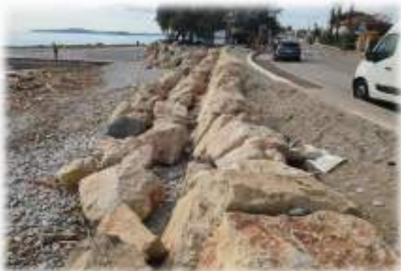
Perré en enrochements protégeant la route
