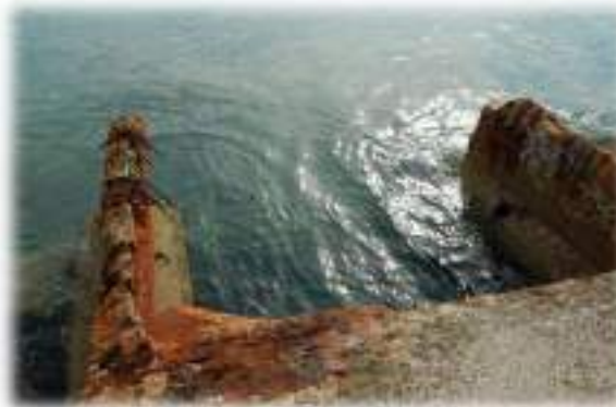
Terminaison d'un épi (cadre en béton) endommagée
