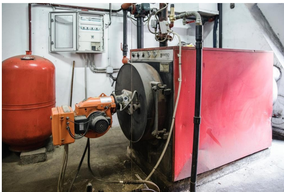
La nuova centrale termica dell'Istituto G.Galilei
