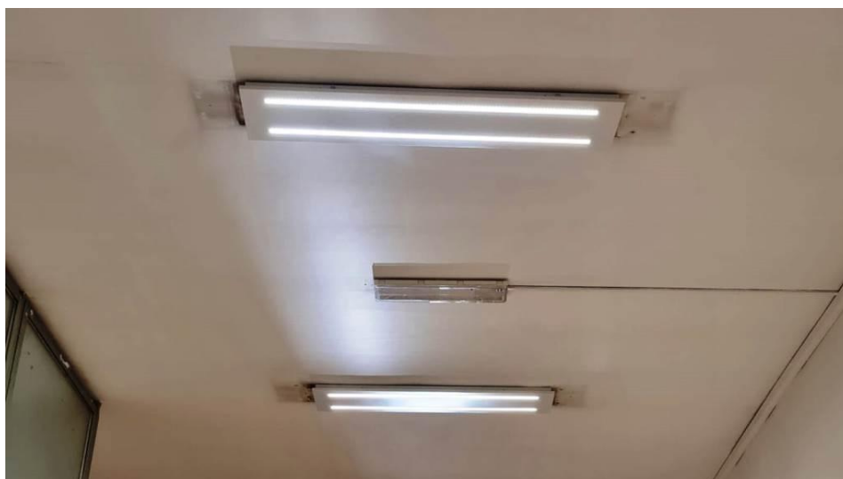
Il nuovo sistema di lampade LED ad alta efficienza e controllo domotico
